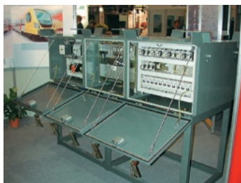
図II-10.3 補助電源の外観
